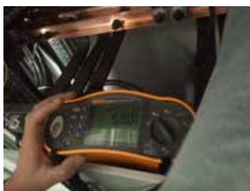
Teste de isolamento
